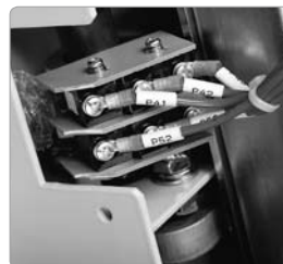
Контакт индикации срабатывания заземляющего устройства
