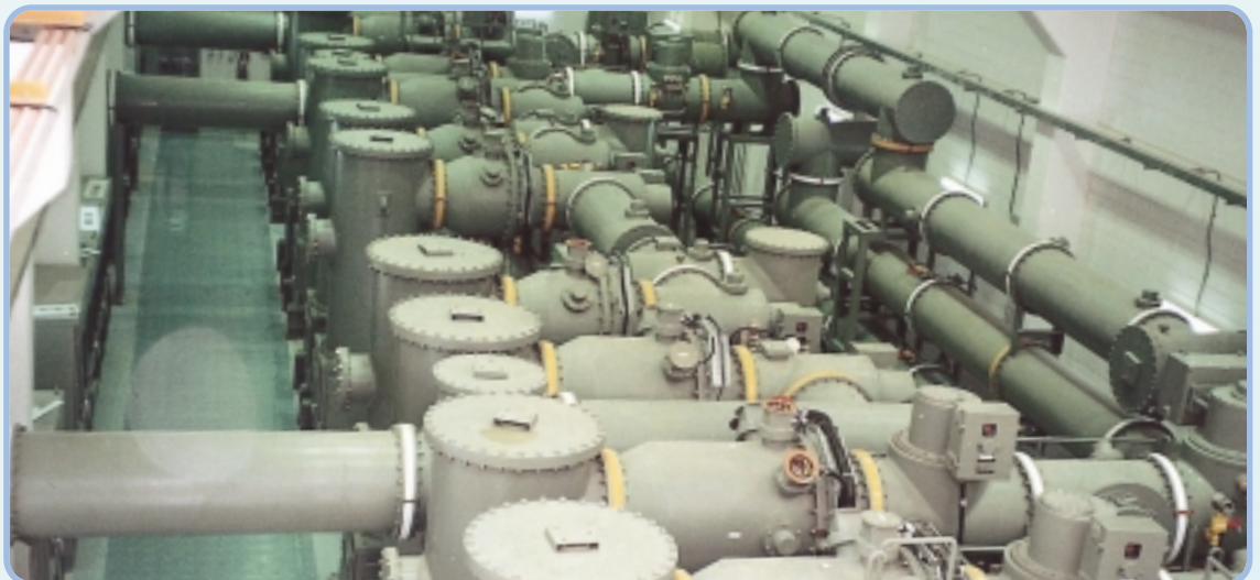
145 kV 40 kA GIS
