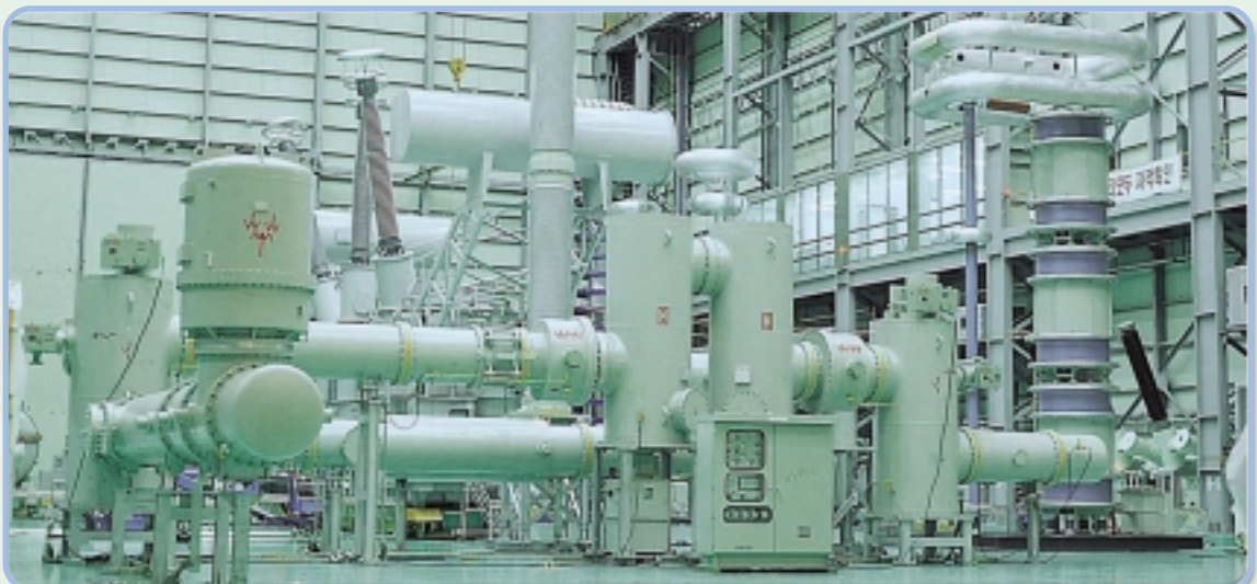
800 kV 50 kA GIS
